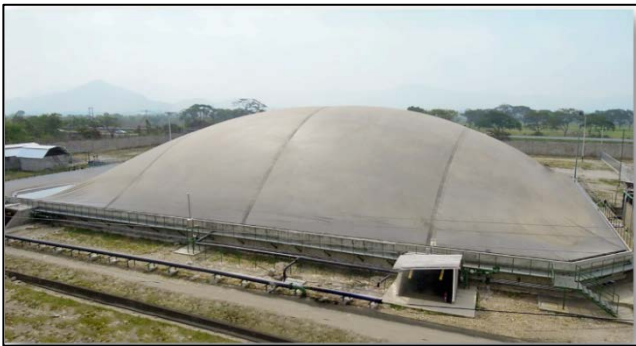
Figura 2: Biodigestor tipo laguna cubierta instalado en Matadero El Pazo [17]. Fuente: Aqualimpia, 2012
