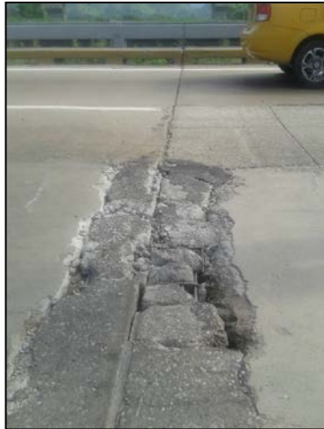
Figura 21: Patrón de Agrietamiento en juntas de dilatación de tableros mixtos (13 m). Fuente: Elaboración propia
