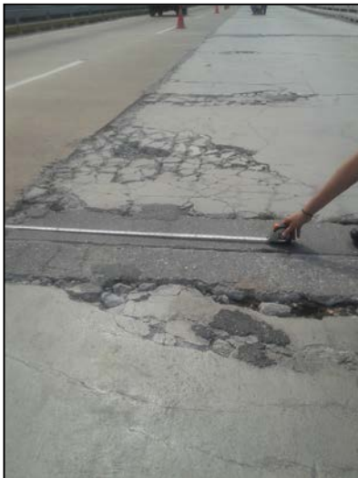
Figura 22: Patrón de Agrietamiento en juntas de dilatación de la zona central de viaducto. Fuente: Elaboración propia
