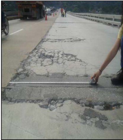
Figura 17: Patrón de agrietamiento típico en zona central del tablero. Fuente: Elaboración propia
