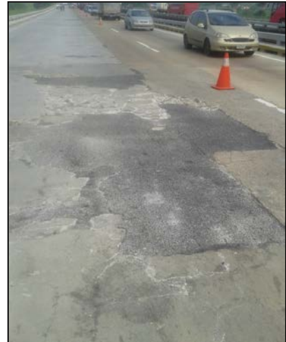
Figura 18: Patrón de Agrietamiento en tableros mixtos (13 m). Fuente: Elaboración propia
