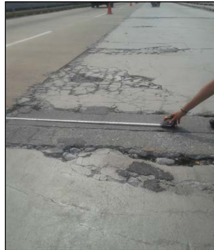
Figura 16: Patrón de agrietamiento típico en zona central del tablero. Fuente: Elaboración propia
