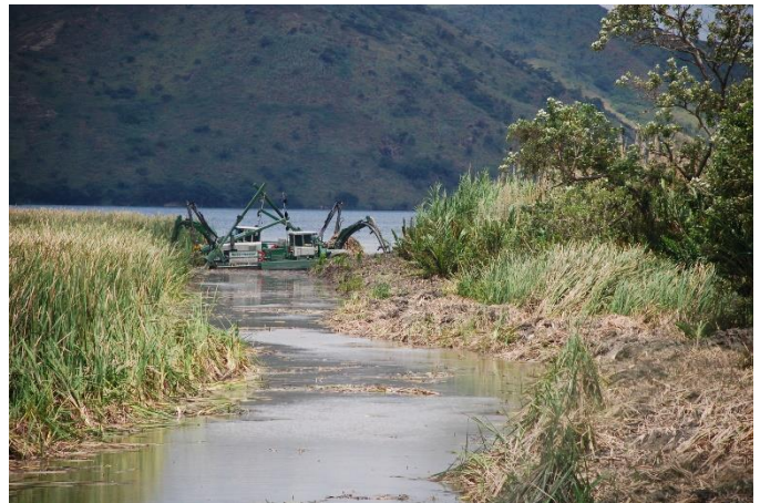
Figura 8: Equipos Pequeños de Dragado cuyo Trabajo se Dirige a Permitir el Paso de Agua entre los Dos Sectores del Embalse (2017)
