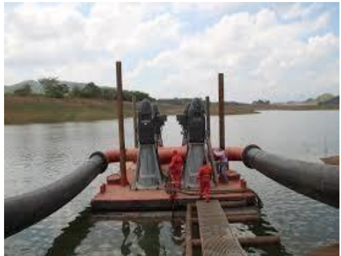
Figura 27: Balsa con las Bombas. (Fuente: Internet)
