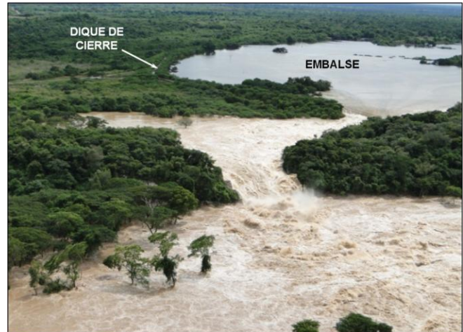
Figura 7: Vista Desde Aguas Abajo de la Rotura del Dique de Cierre (05/12/2010). (Cortesía de HIDROLAGO – Pedro Montes)
