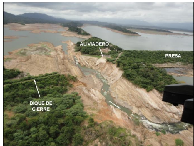
Figura 8: Zanjón Erosivo Formado en el Sitio de la Rotura del Dique
