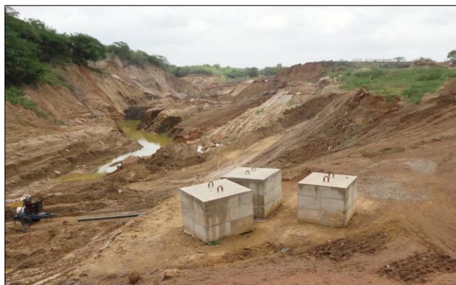
Figura 11: Bloques Prefabricados de Concreto, Utilizados para Controlar el Flujo en el Zanjón
