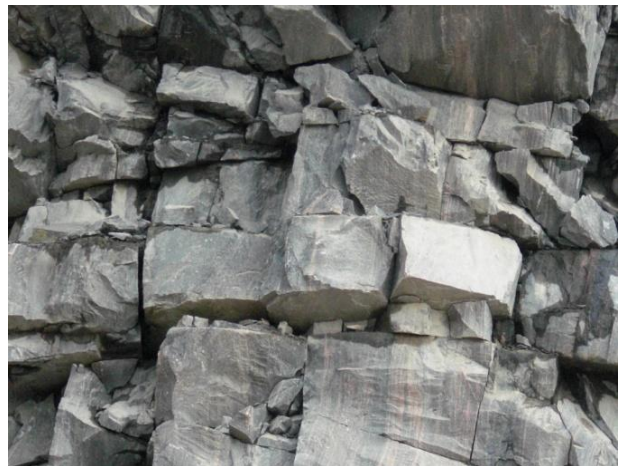
Figura 5: sistemas de fractura desarrollados en el frente excavación del canal de descarga de la presa Tocoma. Capítulo 8. Sección 8.2. [1].
