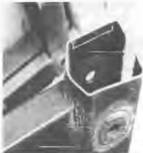
Detalles de la fractura frágil de la conexión tubular soldada, la distorsión de la sección transversal y de la corrosión en la zona de máximas tensiones.
