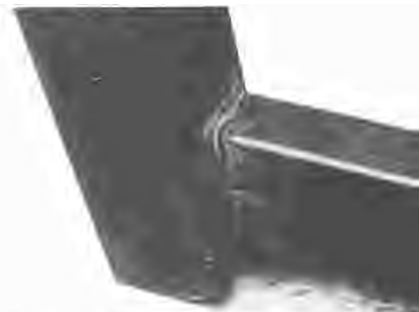
Detalle de la fractura frágil de la conexión tubular soldada. Obsérvese la intensa corrosión en la zona soldada y de máximas tensiones.
