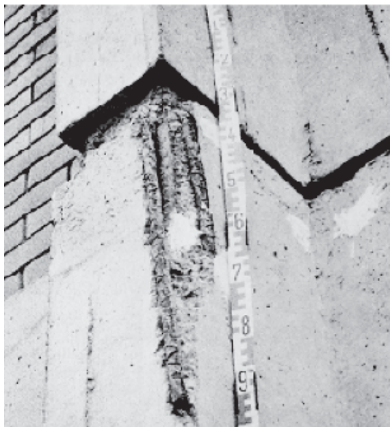
Foto B: Columna B1. Caras Oeste y Sur. Desprendimiento del recubrimiento.
