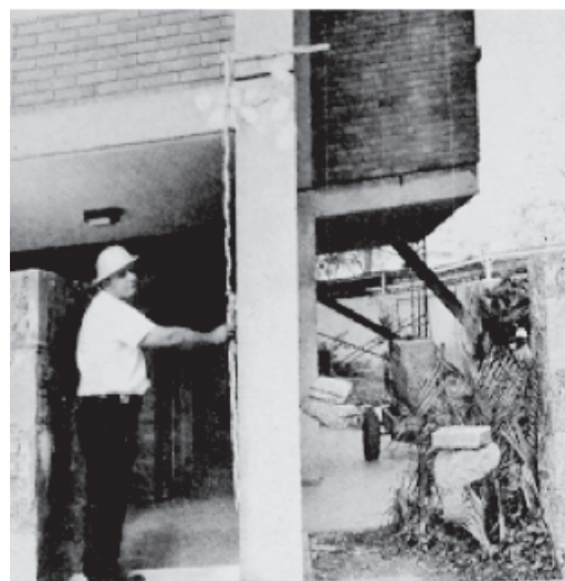
Foto F: Columna D4, cara Este. Grietas en la parte superior.
