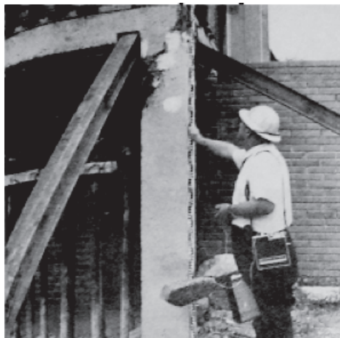
Foto E: Columna D1. Cara Norte. Falla de la columna de PB.
