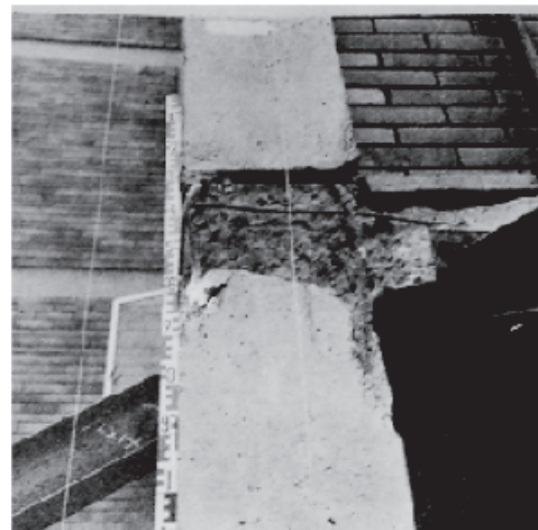
Foto D: Columna D1. Cara Oeste. Detalle de la falla en la parte superior.
