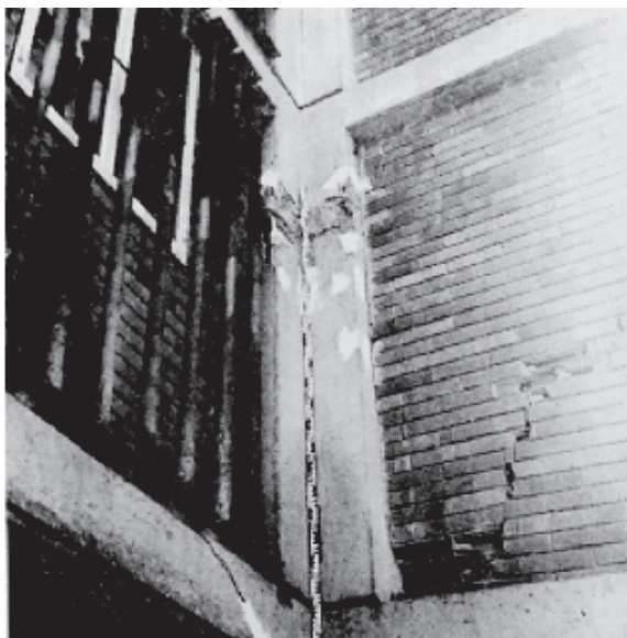
Foto A: Columna A2 del 1º piso. Desprendimiento del concreto.
