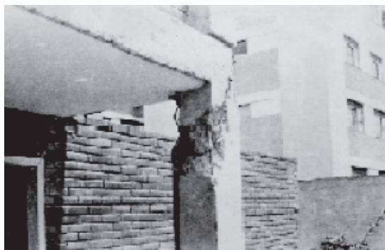
Foto C: Columna D1. Caras Este y Norte. Falla total con desprendimiento del concreto y deformación de barras.
